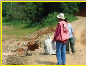
สำรวจตรวจสอบพื้นที่ดินถล่ม
