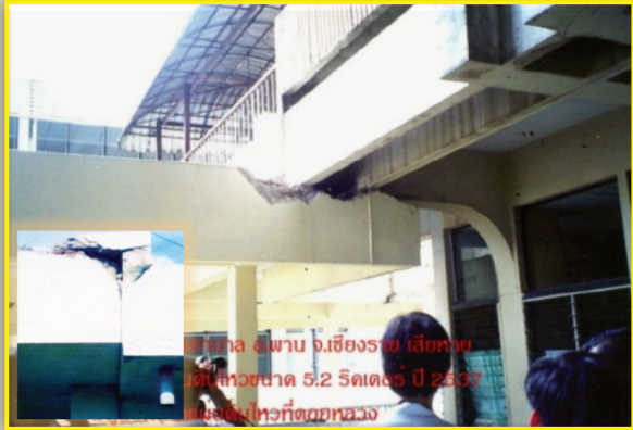
พ.ศ. 2537 โรงพยาบาลพาน อ.พาน จ.เชียงราย อาคารแตกร้าว ขนาดแผ่นดินไหวคือ 5.2 (ศูนย์กลางในดอยหลวง)
