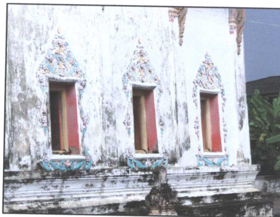
รูปภาพสภาพก่อนการบูรณะซุ้มหน้าต่างโบสถ์
