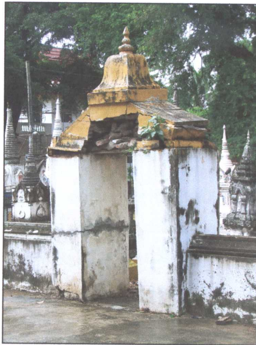
รูปภาพก่อนดำเนินการบูรณะซุ้มประตูหมายเลข ๒
