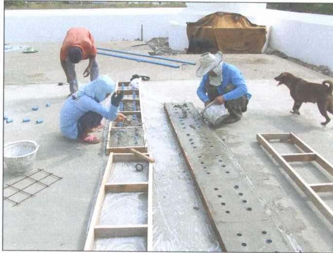
รูปภาพขณะดำเนินการเทคอนกรีตฝารางระบายน้ำ
