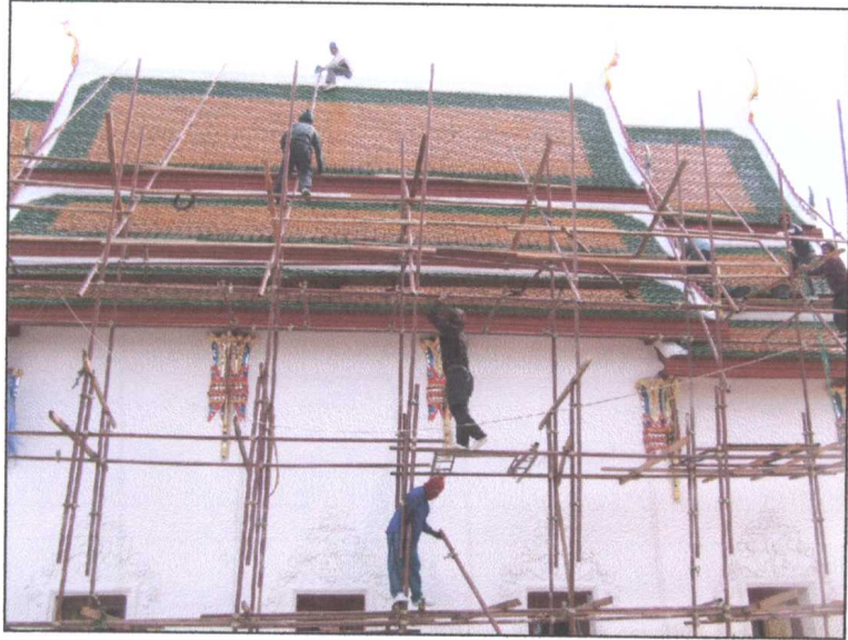
รูปภาพเมื่อดำเนินการซ่อมแซมหลังคาแล้วเสร็จ
