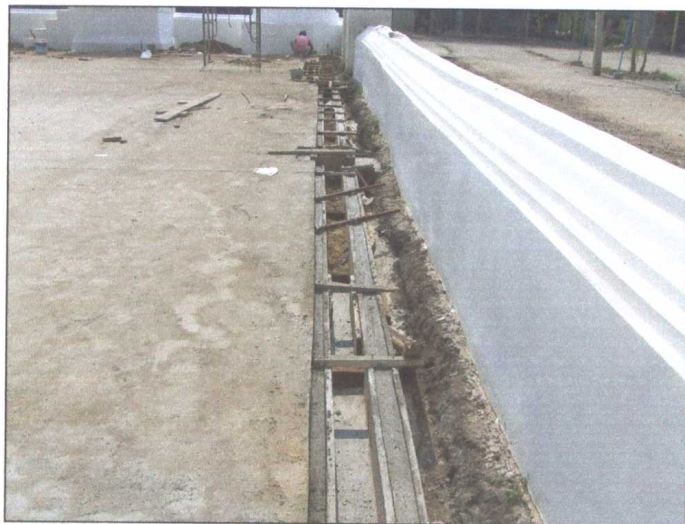
รูปภาพขณะดำเนินการเทคอนกรีตผนังรางระบายน้ำ
