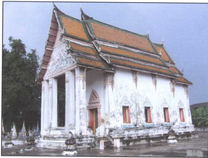
รูปภาพหลังคาโบสถ์ก่อนการบูรณะ
