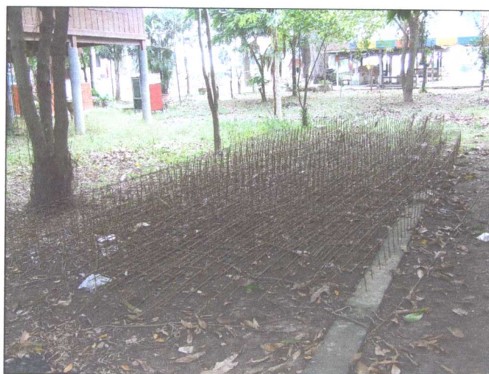
รูปภาพขณะดำเนินการผูกเหล็กเสริมรางระบายน้ำ
