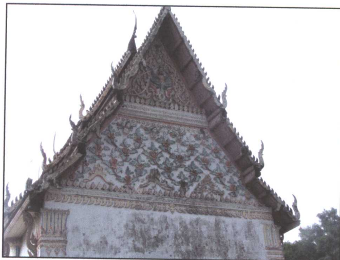
รูปภาพสภาพก่อนการบูรณะหน้าบันด้านหลังโบสถ์
