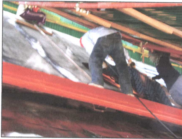
รูปภาพขณะดำเนินการติดตั้งแผ่นยางสังเคราะห์
