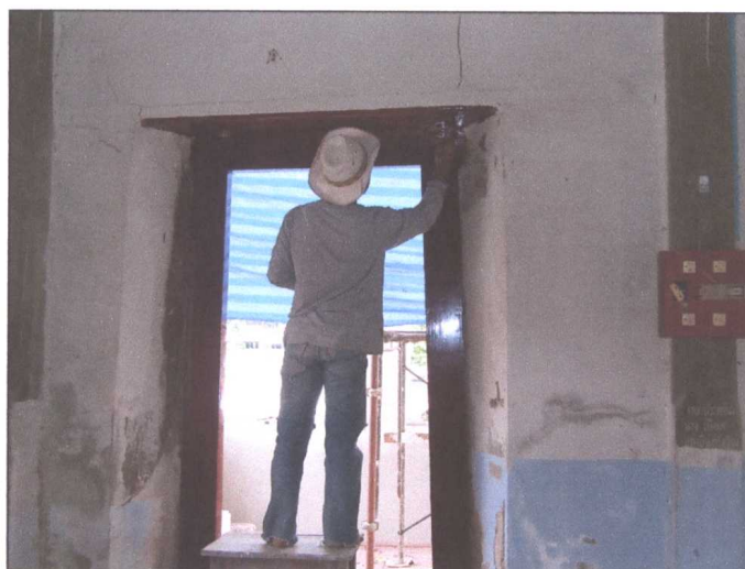
รูปภาพขณะดำเนินการทำสีวงกบประตู-หน้าต่าง
