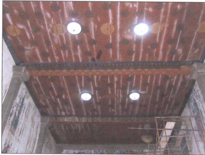
รูปภาพก่อนดำเนินการซ่อมแซม
