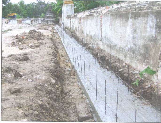
รูปภาพขณะดำเนินการเทคอนกรีตพื้นรางระบายน้ำ
