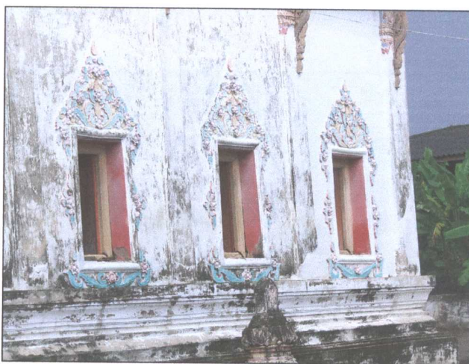
รูปภาพก่อนดำเนินการซ่อมแซม
