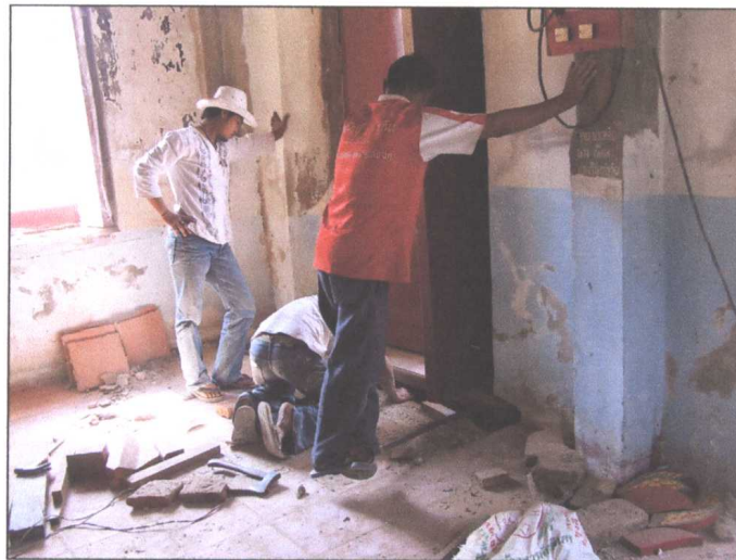
รูปภาพขณะดำเนินการติดตั้งบานประตู-บานหน้าต่าง
