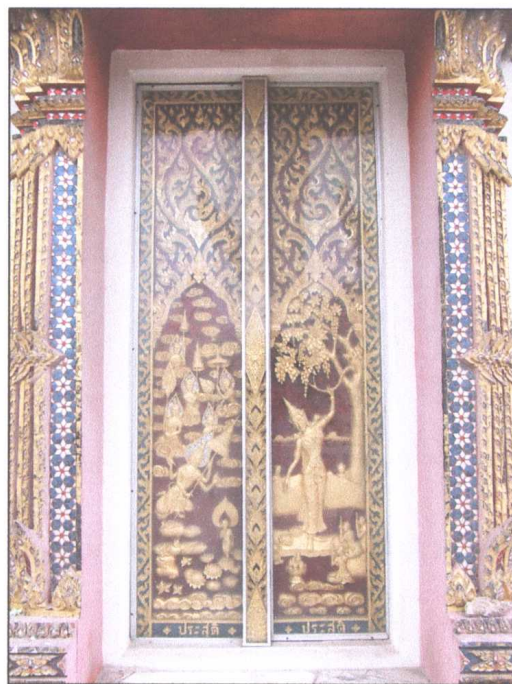
รูปภาพเมื่อดำเนินการซ่อมแซมประตู-หน้าต่างแล้วเสร็จ
