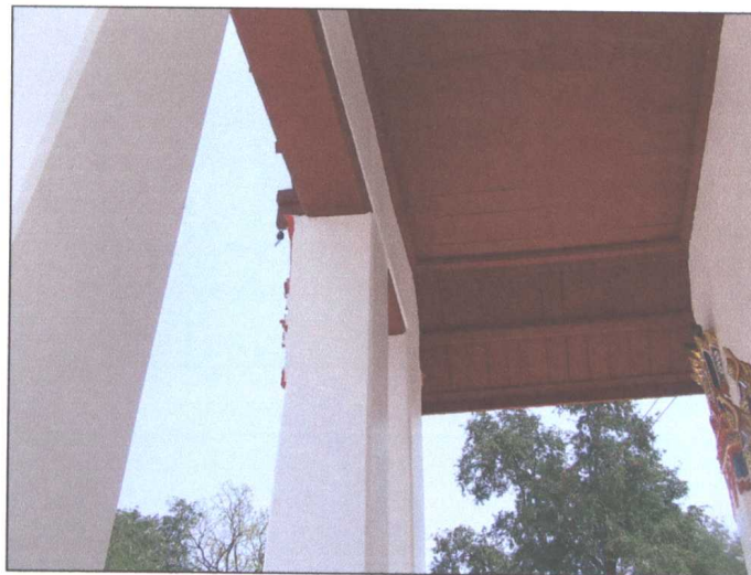
รูปภาพขณะดำเนินการซ่อมแซมฝ้าเพดานภายนอกแล้วเสร็จ
