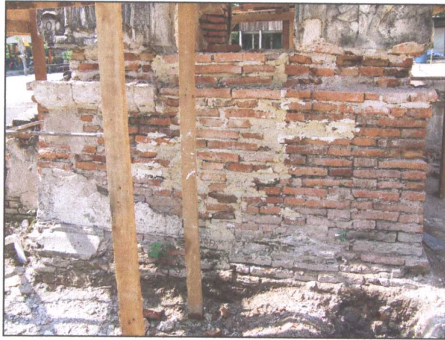
รูปภาพขณะดำเนินการสกัดผิวปูนฉาบเดิมที่ชำรุดออก
