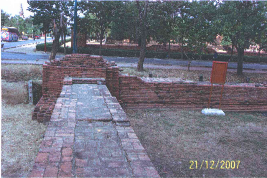
ภาพที่ ๓ รอยร้าวบริเวณกำแพงวัดทางด้านทิศตะวันตกเฉียงเหนือ
