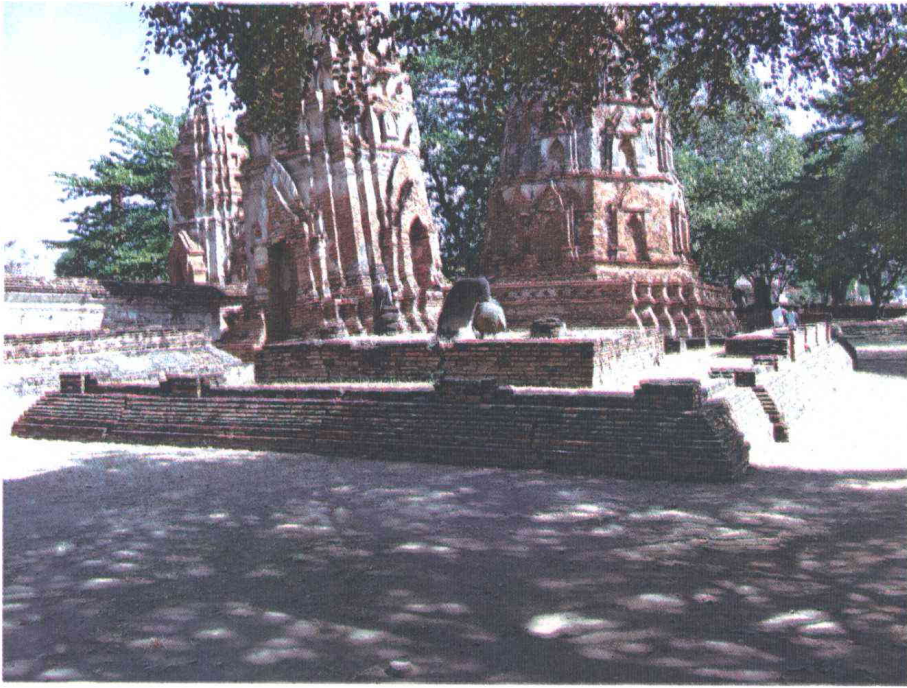
ภาพที่ ๗ รอยราวของแนวอิฐบริเวณฐานโบราณสถาน
