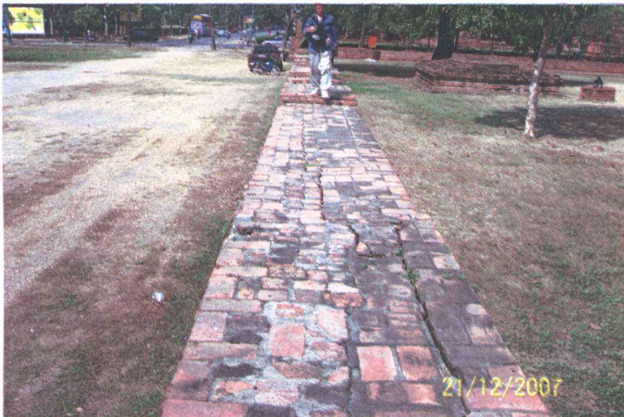
ภาพที่ ๔ รอยร้าวบริเวณกำแพงวัดทางด้านทิศตะวันตกเฉียงเหนือ
