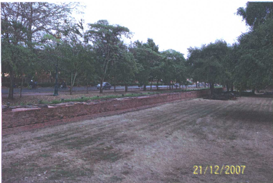
ภาพที่ ๒ รอยร้าวบริเวณกำแพงวัดทางด้านทิศเหนือ
