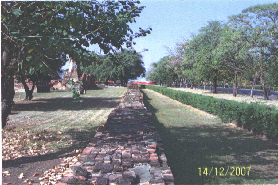
ภาพที่ ๑ รอยร้าวบริเวณกำแพงวัดทางด้านทิศเหนือ
