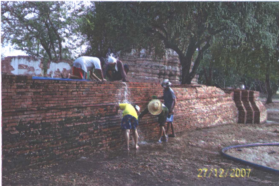
ภาพที่ ๑๖ การขัดล้างทำความสะอาดผิวโบราณสถาน
