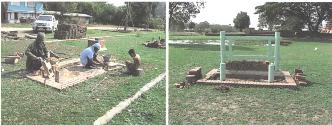
ขณะดำเนินการซ่อมแซมและสร้าง งานป้ายและสาธารณูปโภค
