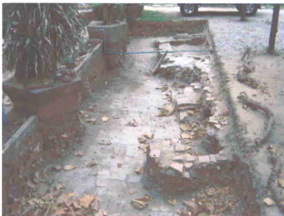
ภาพที่ ๕๗ หลุมขุดตรวจหาแนวโบราณสถานหมายเลข 14
