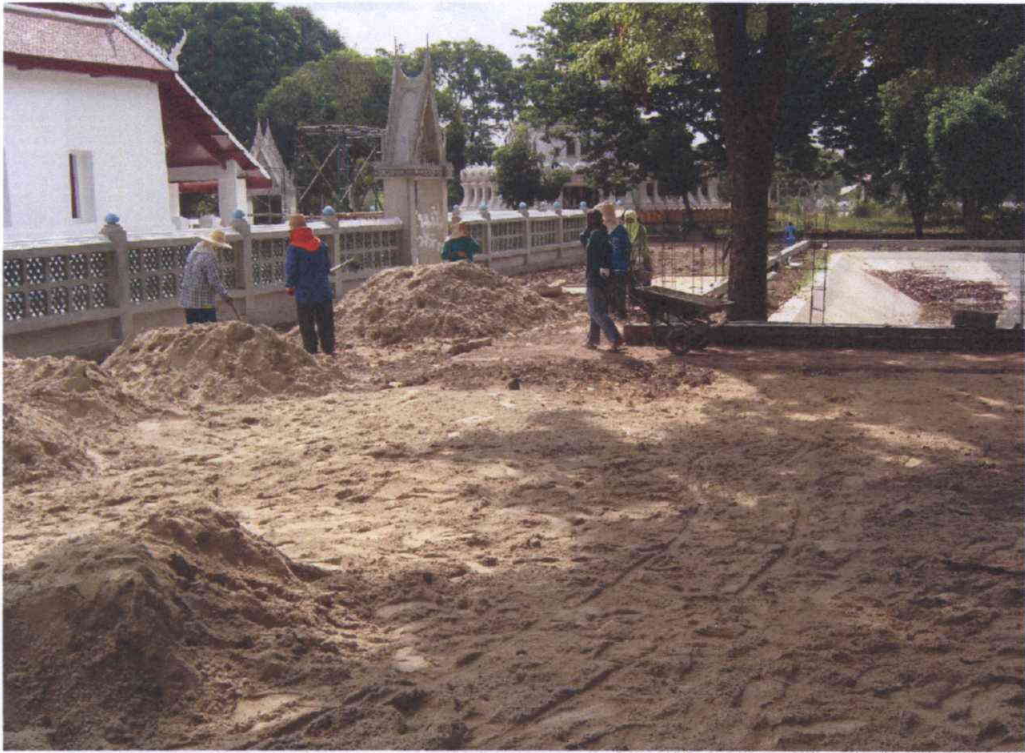
คนงานกำลังปรับเกลี่ยหน้าดินด้านข้างฝั่งสระน้ำ
