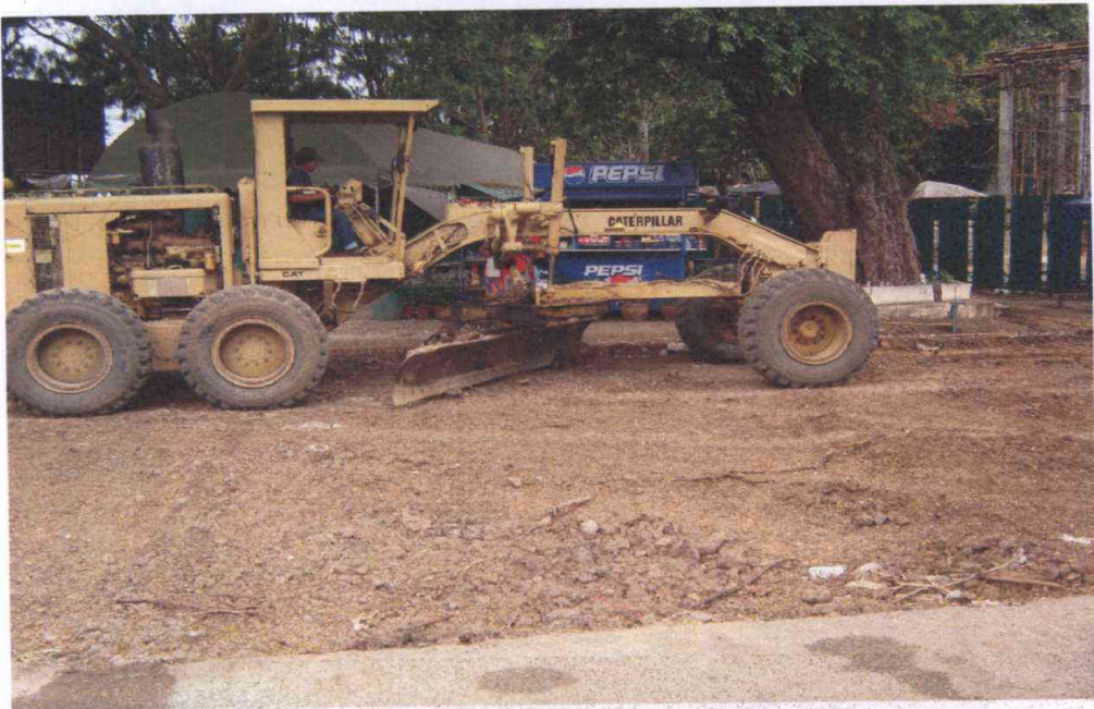
งานใช้เครื่องจักรหนักในการปรับหน้าดินบริเวณลานจอดรถ
