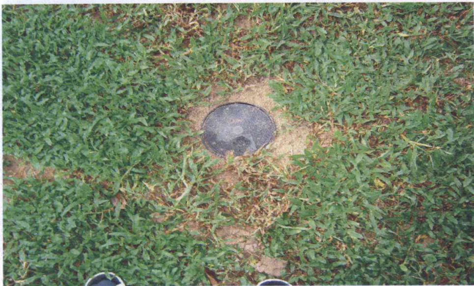
หัวจ่ายน้ำ ระบบ POP UP
