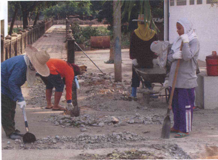
ทำการสกัดพื้นถนนจากศาลาท่าน้ำเพื่อวางแนวขอบอิฐ บปก
