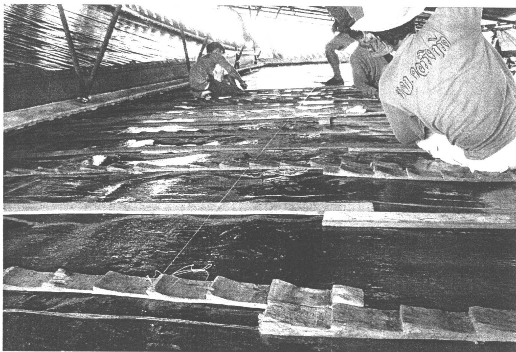
ภาพที่ 32 แสดงภาพการติดตั้งไม้กลอนและไม้ระแนงของเดิมและเสริมใหม่ในส่วนที่ชำรุดพร้อม ปรับระดับใหม่
