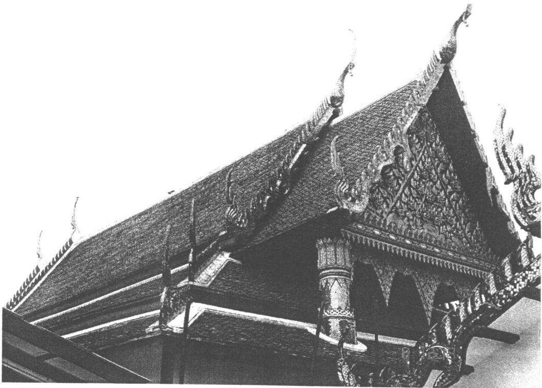
ภาพที่ 2 แสดงสภาพกระเบื้องหลังคา สันหลังคา หลบหลังคา ก่อนการบูรณะ
