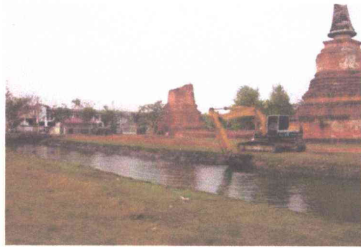
ภาพที่ 36 ดำเนินการขุดลอกคูน้ำ ทะเบียนภาพถ่าย: วัดหัตถดาต - 081
