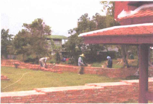
ภาพที่ 41 ก่ออิฐเสริม กำแพงแก้ว ด้านตะวันออก ทะเบียนภาพถ่าย: วัดหัสตาวาส - 231
