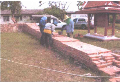
ภาพที่ 43 ก่ออิฐเสริม กำแพงแก้ว ด้านตะวันออก ทะเบียนภาพถ่าย: วัดหัสตาวาส - 211
