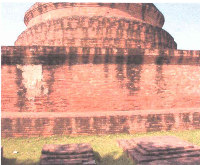
ภาพที่ 14 ฐานเชิงของเจดีย์ทรงกลมบนฐาน สี่เหลี่ยมสูง ด้านทิศใต้ ก่อนดำเนินการบูรณะฯ ทะเบียนภาพถ่าย : หัสดาวาส - 012
