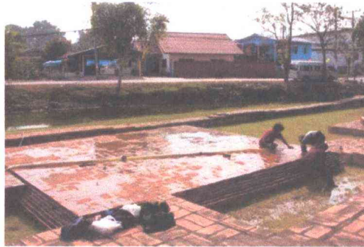
ภาพที่ 32 ดำเนินการขัดล้างโบราณสถาน ทะเบียนภาพถ่าย: วัดหัตถดาวาส - 075
