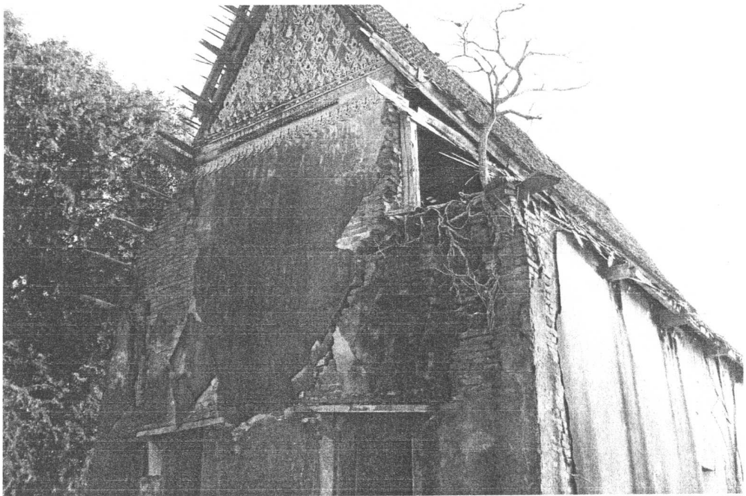
ภาพที่ ๑๐ สภาพอุโบสถด้านทิศใต้ก่อนการดำเนินงานบูรณะ
