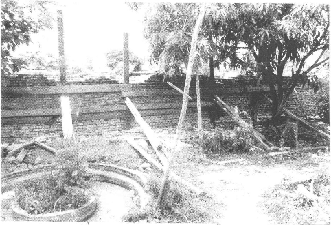
รูปที่ 60 การปรับดีดแนวกำแพงแก้วทิศเหนือ ด้านทิศใต้ (ด้านใน) (ฟิล์ม 8/9)
