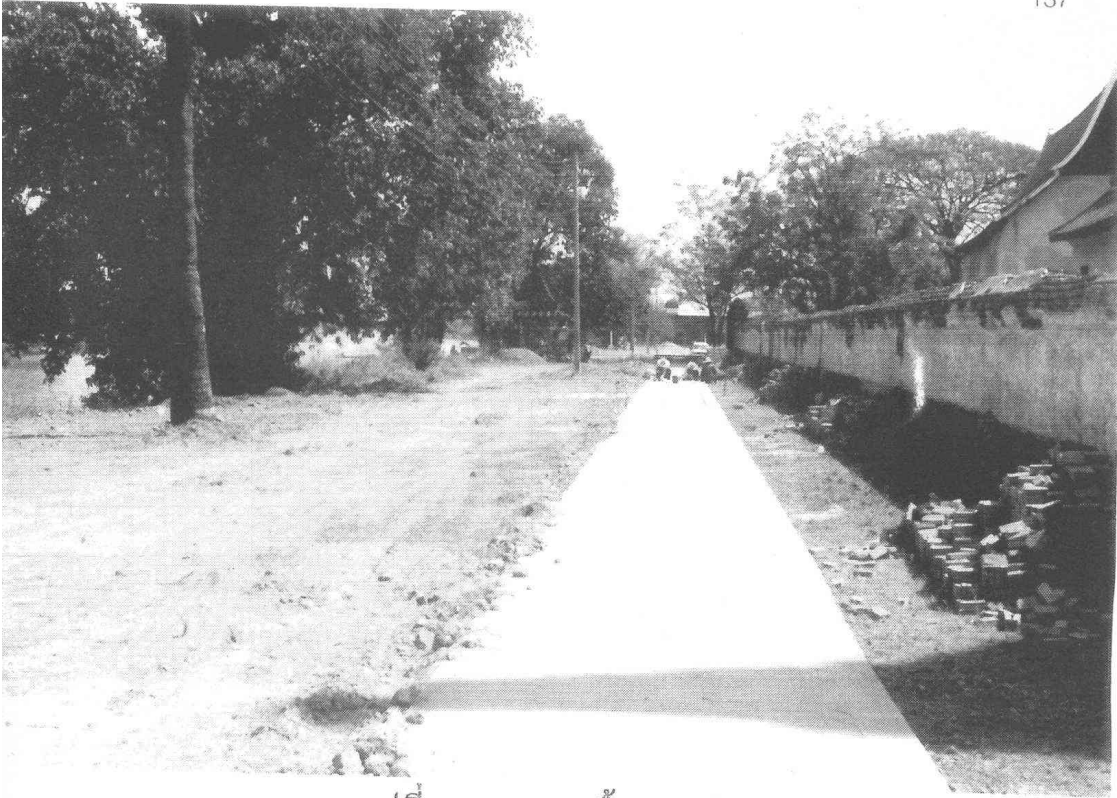
รูปที่ 107 งานพื้นทางเดิน ขณะทำการปูพื้นอิฐมอญ ด้านนอกกำแพงแก้วทิศเหนือ (ฟิล์ม 17/21)
