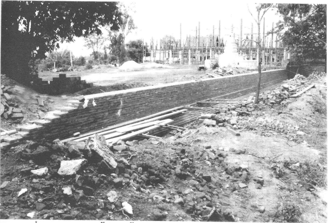
รูปที่ 54 กำแพงแก้วทิศใต้ ขณะทำการบูรณะด้านทิศเหนือ (ด้านใน) (ถ่ายจากทิศตะวันออก) (ฟิล์ม 9/12)
