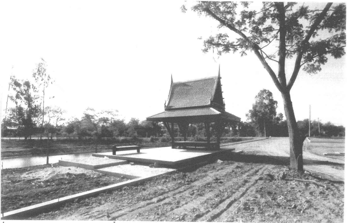
รูปที่ 121 งานอาคารศาลาทรงไทย ขณะทำการก่อสร้างหลังที่ 1 (ฟิล์ม 19/5)
