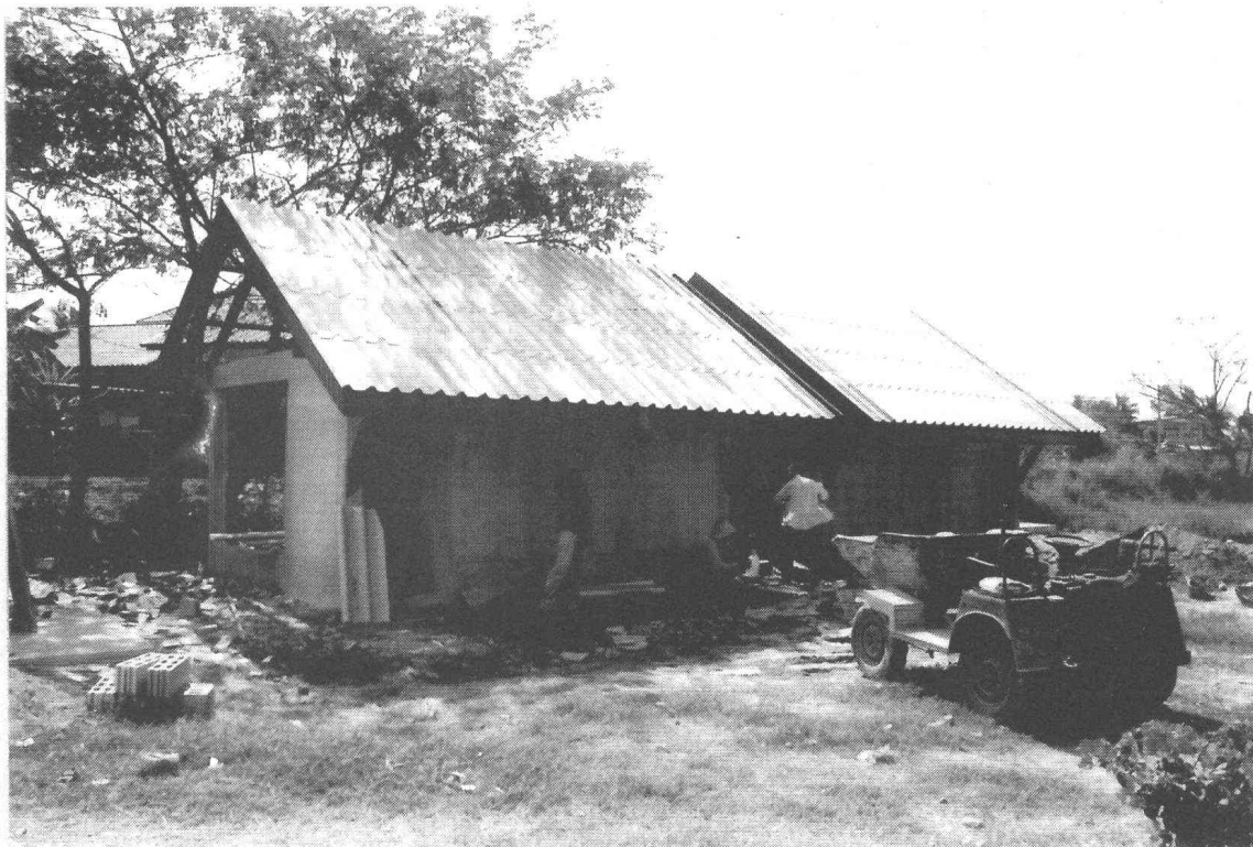
รูปที่ 122 งานอาคารห้องน้ำโรงเรียน ขณะทำการก่อสร้าง (ฟิล์ม 17/17)
