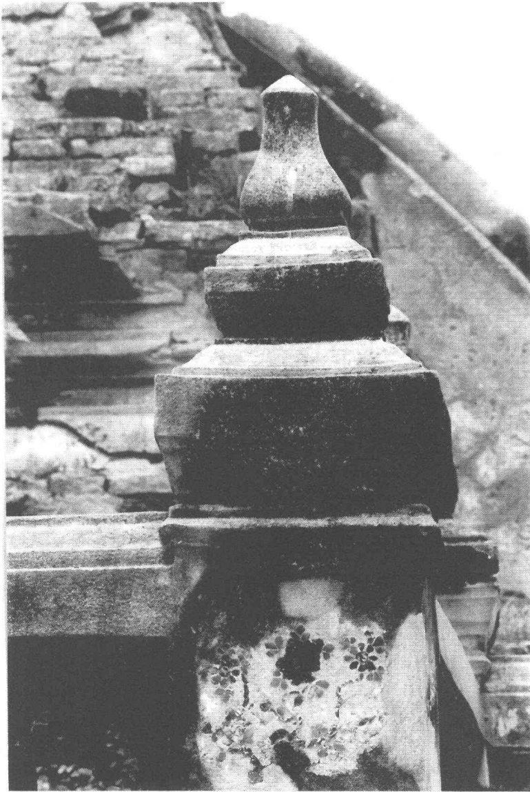
รูปที่ 37 เสากำแพงฐานไพที สภาพก่อนการบูรณะ (ฟิล์ม 5/24)
