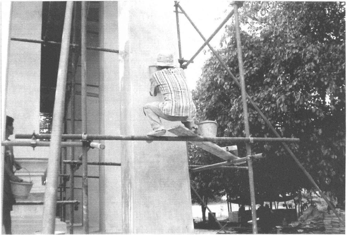
ภาพที่ 11 ขณะปฏิบัติงานฉาบปูน โดยใช้แผ่นฟองน้ำที่เสวป่าไผ่วิหาร ด้านทิศตะวันออกเจียงเหนือ (ฟิล์ม2/20)
