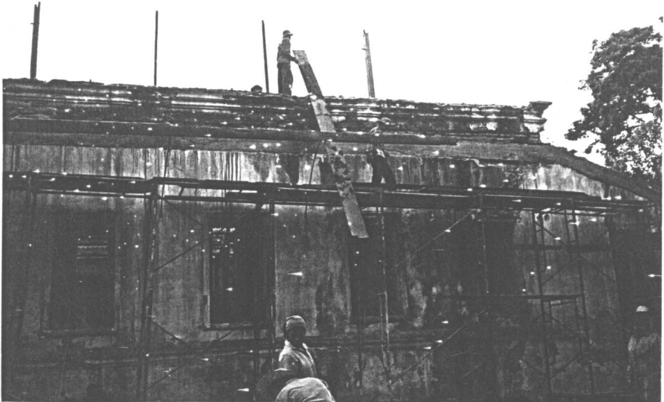
รูปที่ 12 ดำเนินการซ่อมแซมไม้โครงหลังคาและวัสดุผนังหลังคา
