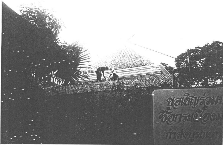
รูปที่ 30 ดำเนินการปูกระเบื้องดินเผาungหลังคา
