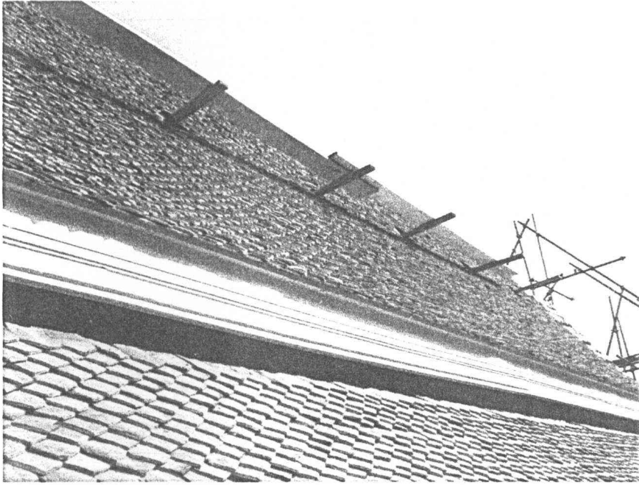
ภาพที่ ๔.๒๒ ซ่อมแซมเปลี่ยนกระเบื้องมุงหลังคาแล้วเสร็จ
