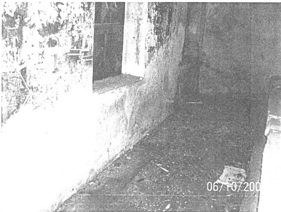
ภาพที่ ๓.๒๔ พื้นภายในอุโบสถ(หลังเก่า) วัดไม้รวกก่อนการบูรณะ
