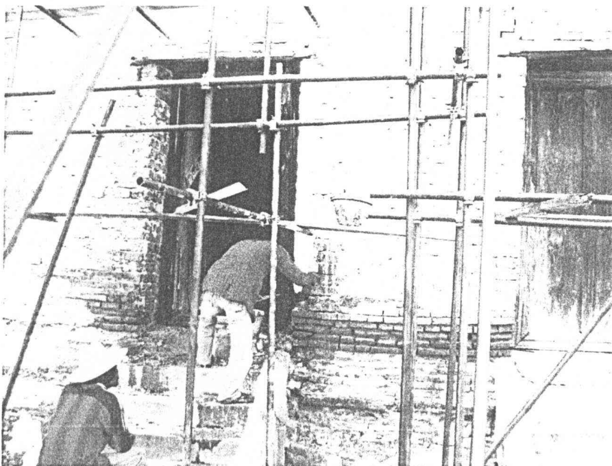
ภาพที่ ๓.๘๖ งานตรวจซ่อมเสริมความมั่นคงผนังเดิม
