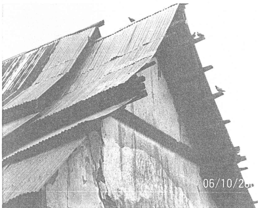
ภาพที่ ๓.๑๒ หลังคาอุโบสถ(หลังเก่า) วัดไม้รวกก่อนการบูรณะ
