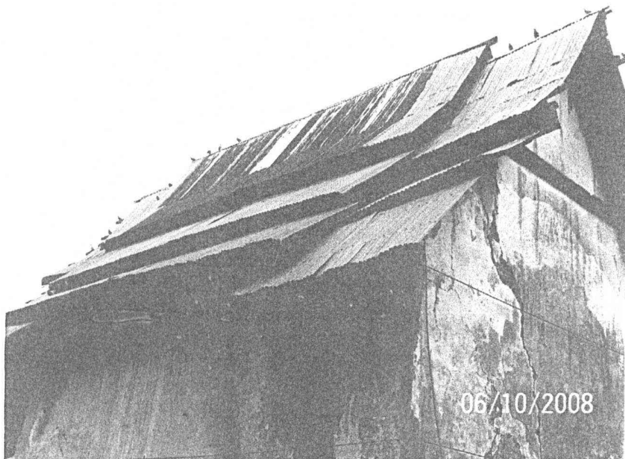
ภาพที่ ๓.๑๑ หลังคาอุโบสถ(หลังเก่า) วัดไม้รวกก่อนการบูรณะ
