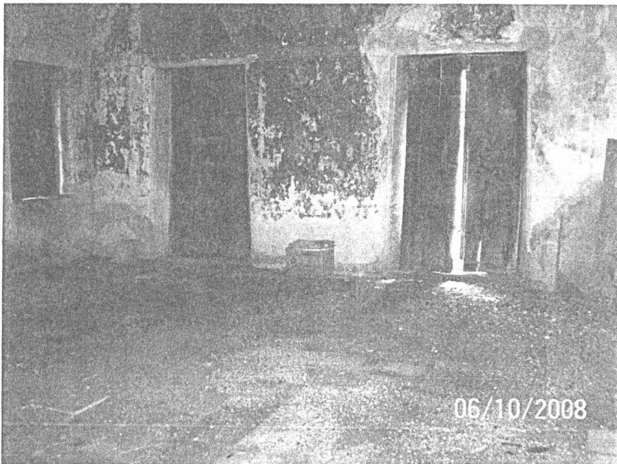
ภาพที่ ๓.๑๘ ช่องประตูอุโบสถ(หลังเก่า)ด้านทิศตะวันออก วัดไม้รวกก่อนการบูรณะ
