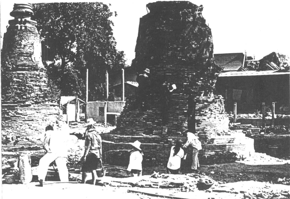
ภาพถ่ายที่20 การเทปูนปิดคานคอนกรีตเสริมเหล็กที่ชั้นบัวลูกแก้ว รอบเจดีย์หมายเลข3 (ฟิล์ม22/5)
