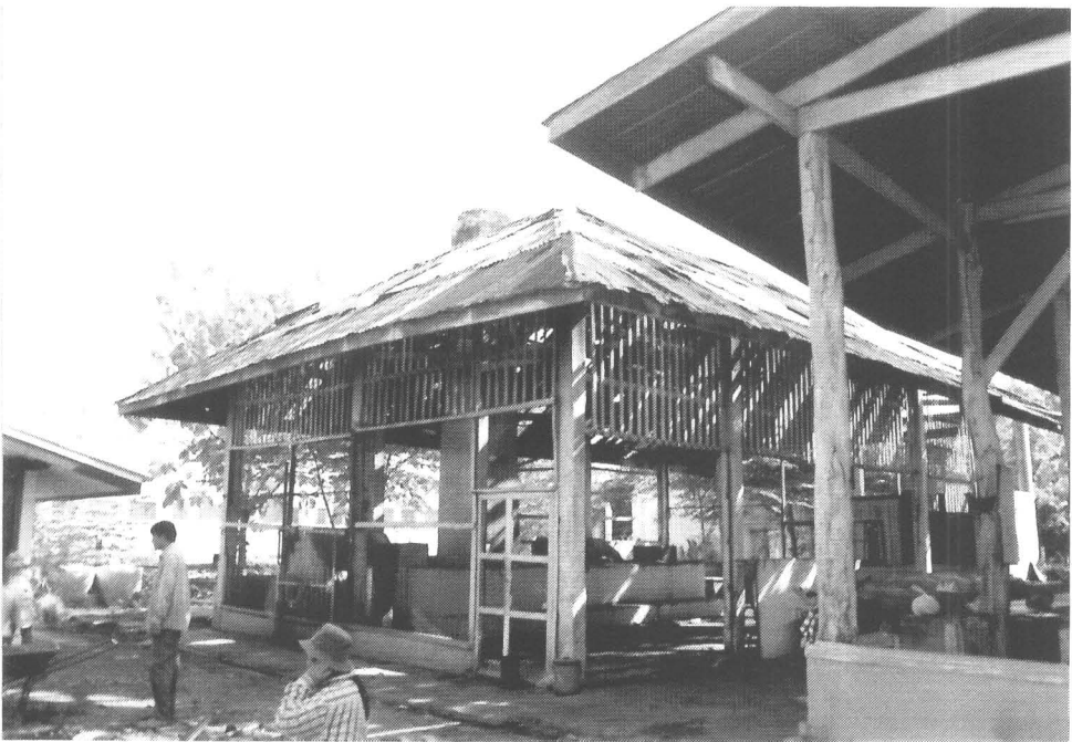
ภาพที่ 6 โรงครัว สภาพก่อนการรื้อถอน (ฟิล์ม 1/13)
