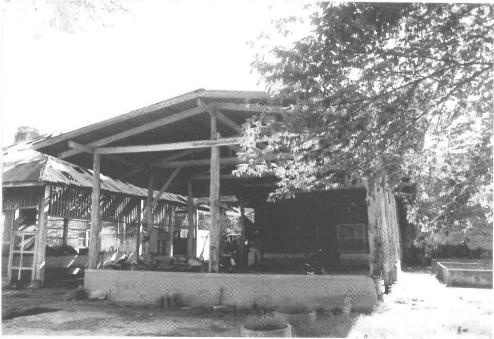
ภาพที่ 5 โรงเก็บเชื้อเพลิง สภาพก่อนการรื้อถอน (ฟิล์ม 1/14)
