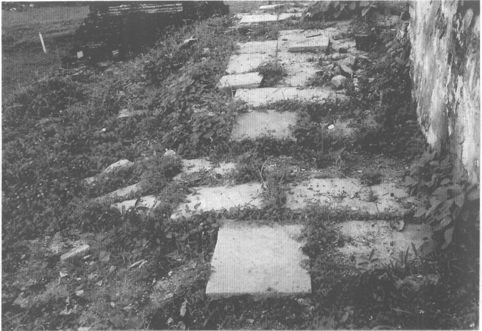
ภาพที่ 5 พื้นปูหินบนลานประทักษิณของเจดีย์ประธาน ก่อนดำเนินการบูรณะ 4/20
