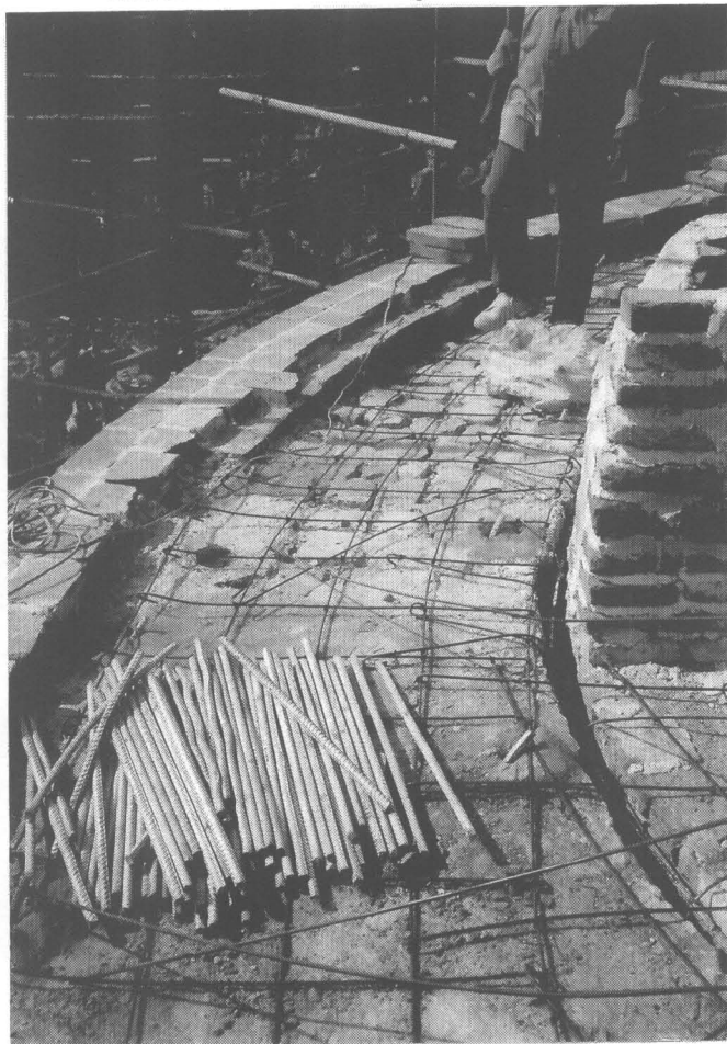
ภาพที่ 48 ดำเนินการเสริมโครงสร้างองค์ระฆังของเจดีย์ประธาน (41/9)
