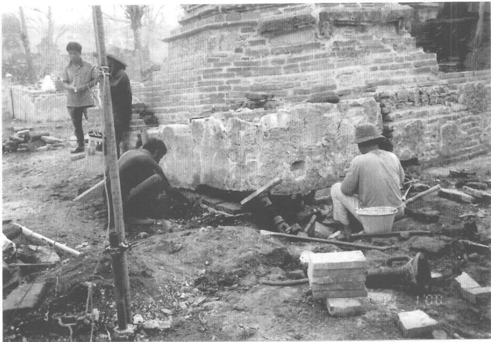
ภาพที่ 96 ก่ออิฐเสริมความมั่นคงบริเวณฐานเจดีย์รายนหมายเลข 10 (11/11)
