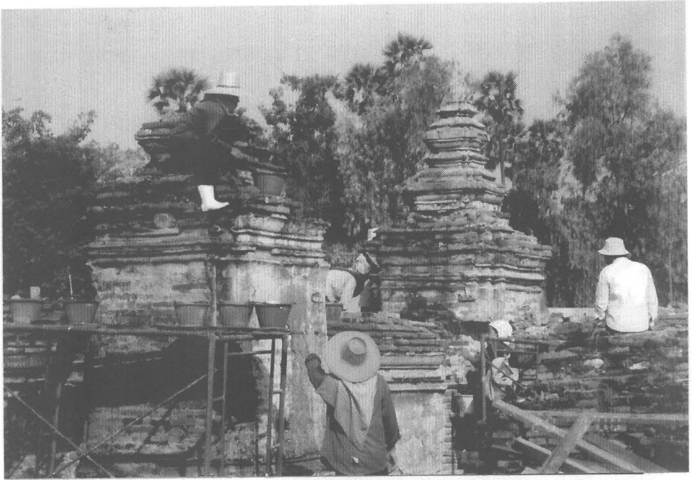
ภาพที่ 113 ดำเนินการทำความสะอาดหัวเม็ดทรงบัณฑ์บริเวณกำแพงแก้ว (12/14)
