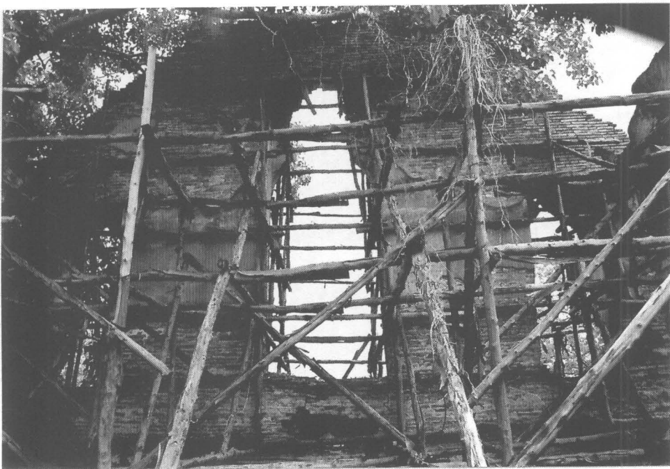
ภาพที่ 28 ผนังด้านในของพระตำหนักกำมะเลียน ก่อนดำเนินการบูรณะ 3/28
