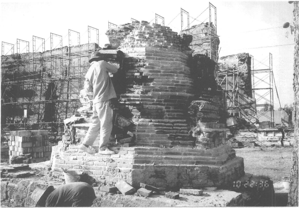
ภาพที่ 97 ซ่อมแซมปูนสอเดิมที่ชำรุดเสื่อมสภาพบริเวณเจดีย์หมายเลข 10 (8/23)
