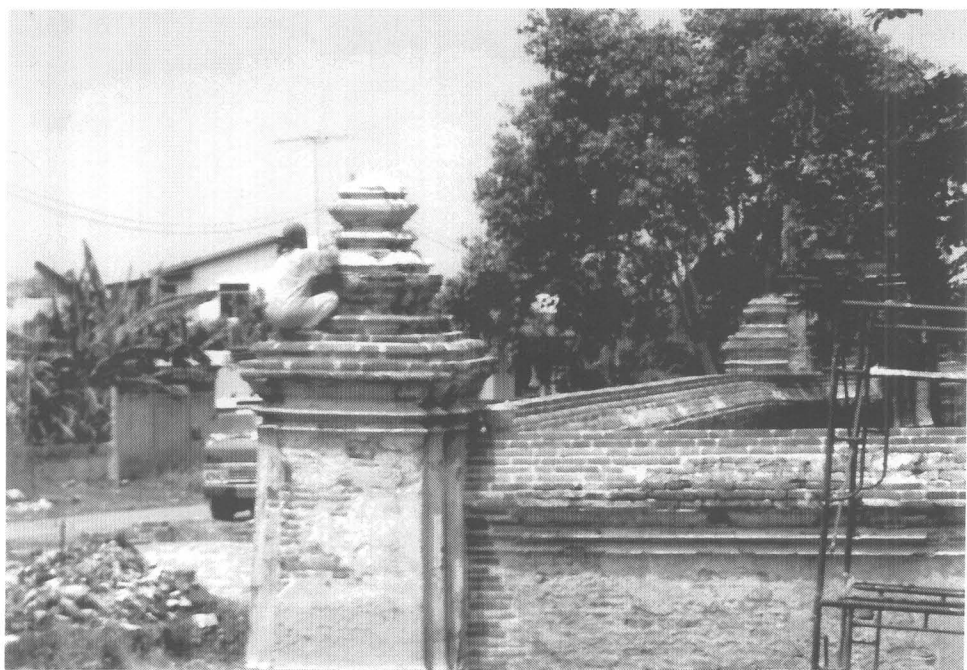
ภาพที่ 120 ดำเนินการอนุรักษ์ผิวปูนฉาบบริเวณเสาหัวเม็ดทรงบิณฑ์ (34/25)
