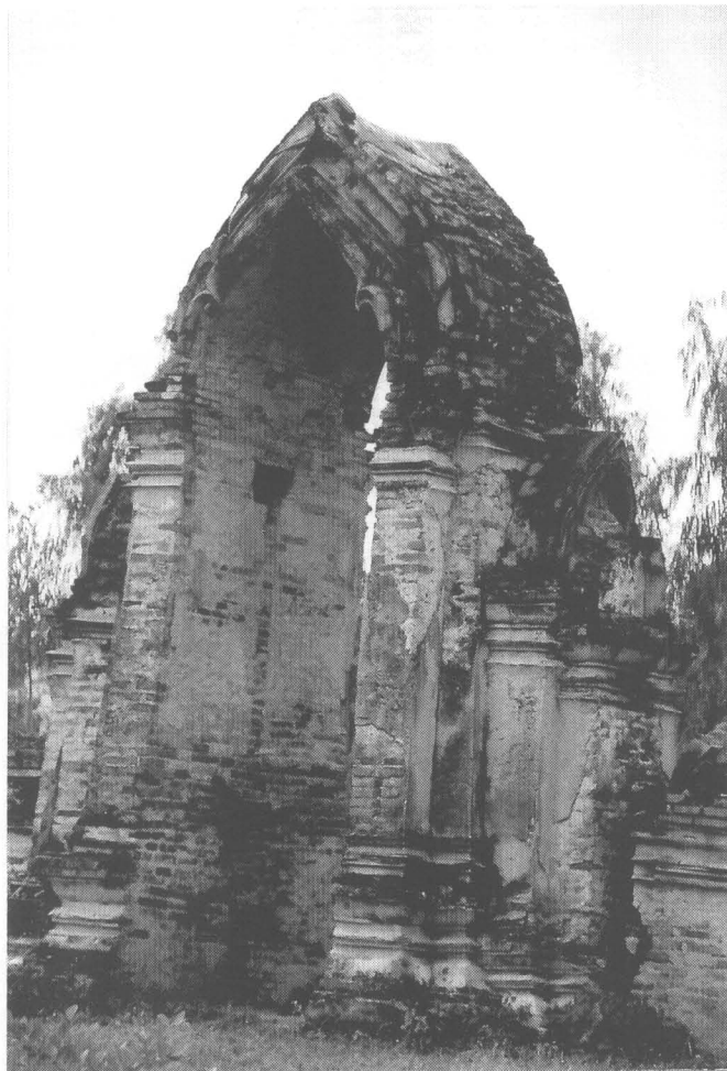
ภาพที่ 44 สภาพโดยทั่วไปของซุ้มประตูทางเข้า ก่อนดำเนินการบูรณะ (3/36)
