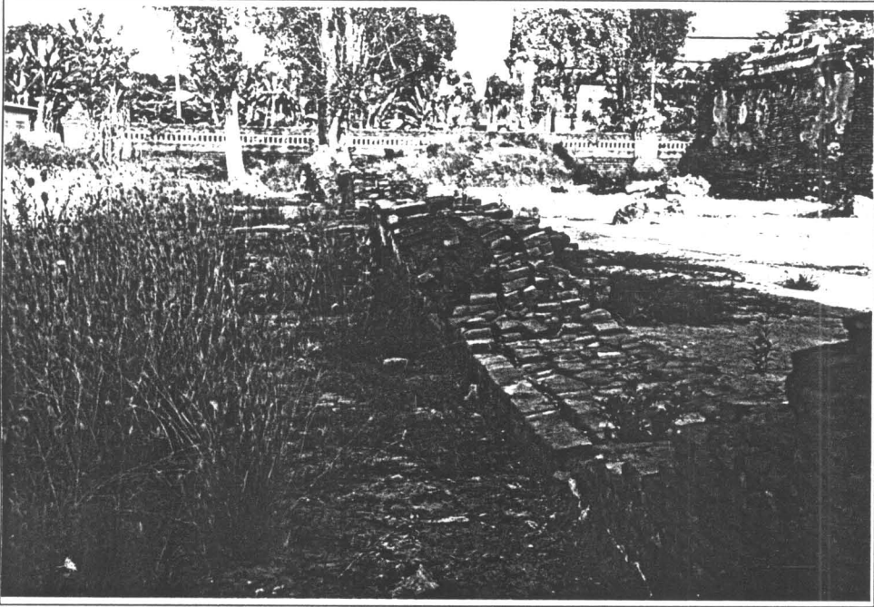
รูปที่ 15 สภาพโดยทั่วไปของแนวกำแพงแก้ว ก่อนดำเนินการบูรณะ (ฟิล์มที่ 2/15)
