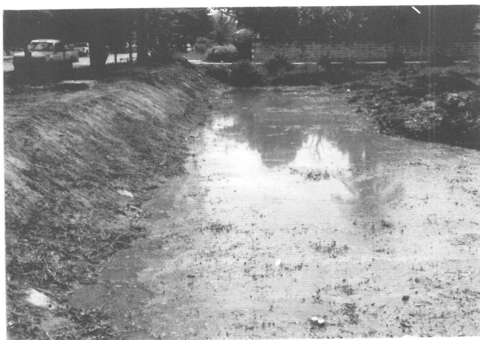
ภาพที่ 28 แนวคูน้ำด้านทิศใต้ ติดถนนเจ้าพรหม ขณะทำการขุดลอก
