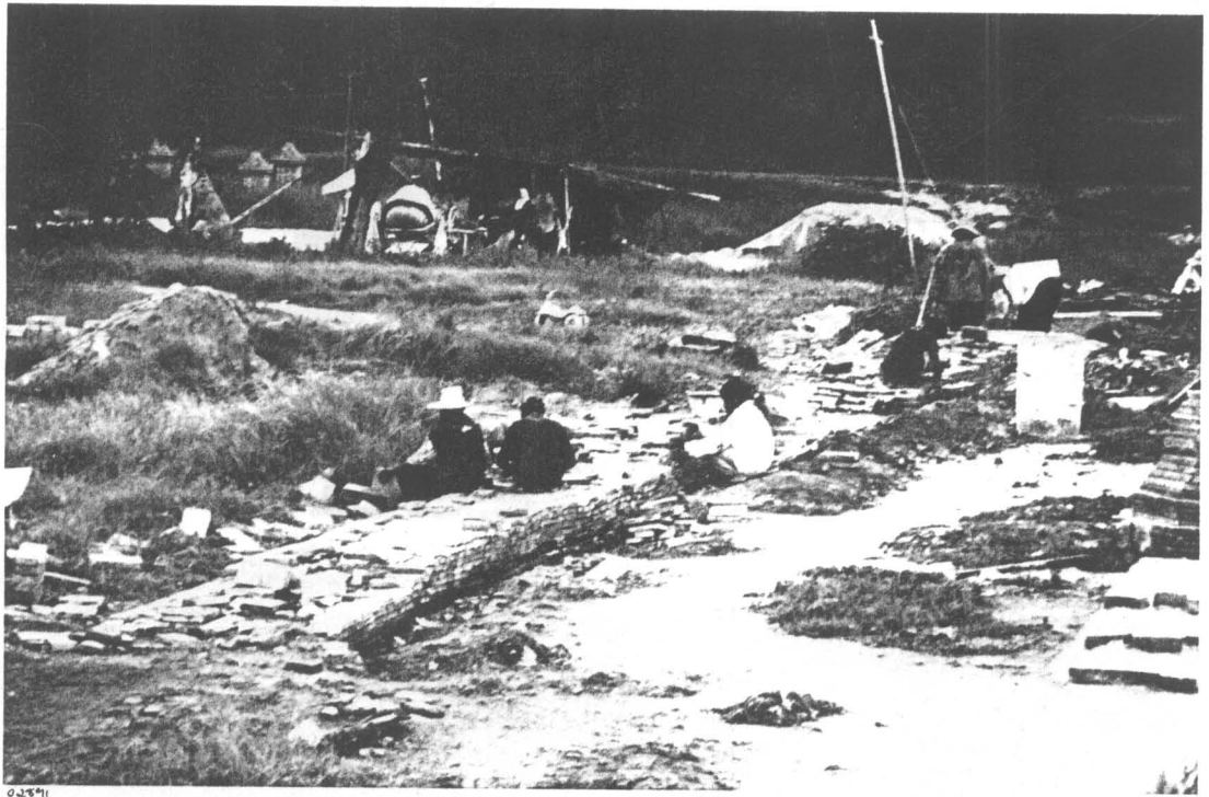
ภาพที่ 268 ภาพแสดง การก่ออิฐบุระกำแพงแก้ว ด้านทิศเหนือ (ฟิล์ม 10/24)
