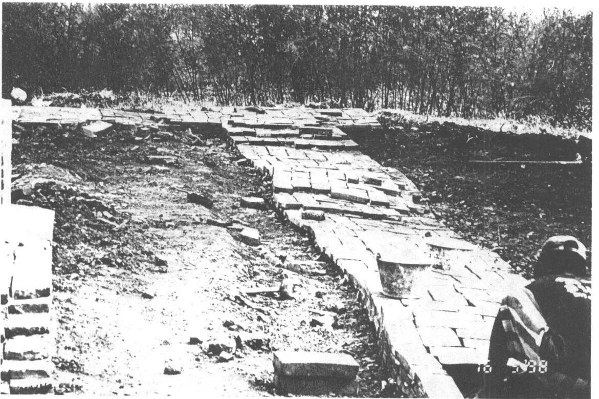
ภาพที่ 264 ภาพแสดง การก่ออิฐบุผนังกำแพงแก้ว ด้านทิศตะวันตก (ฟิล์ม 16/36)
