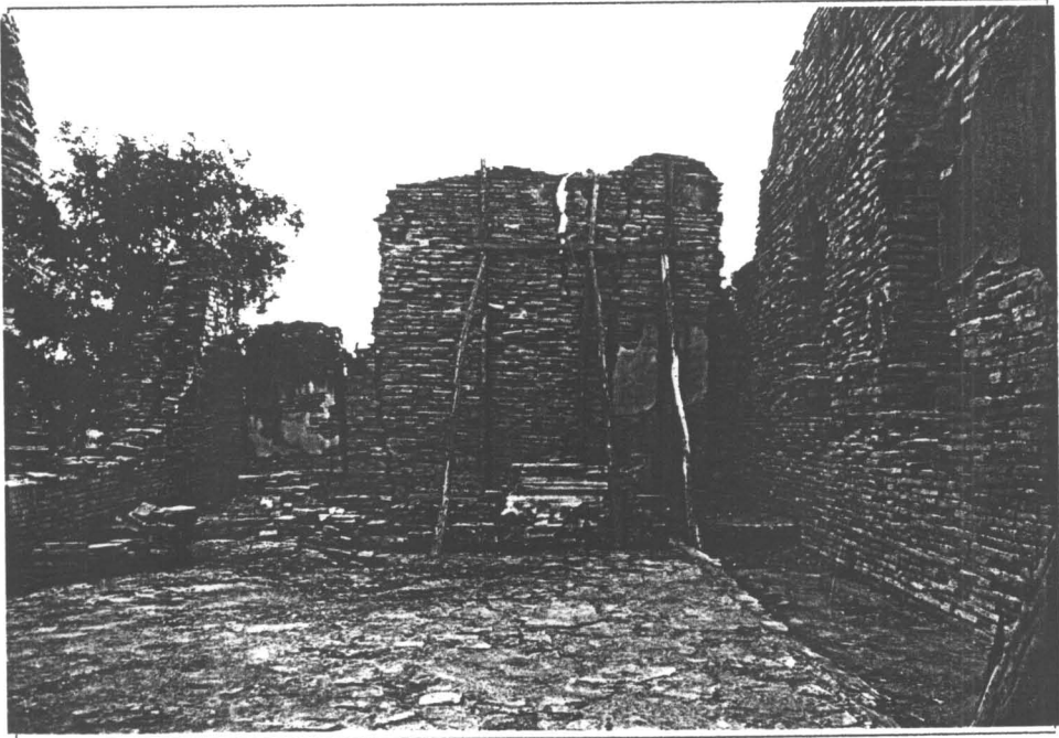
รูปที่ 10 สภาพภายในอุโบสถ ก่อนดำเนินการบูรณะ
