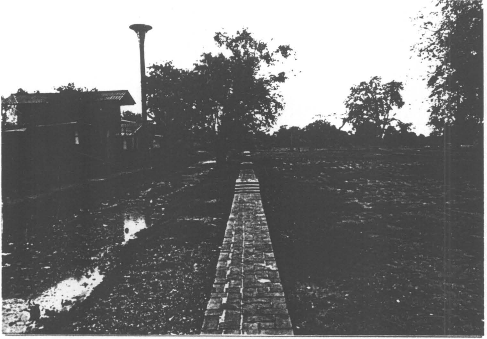
รูปที่ 83 แนวกำแพงวัด ภายหลังจากดำเนินการบูรณะ (31/31)
