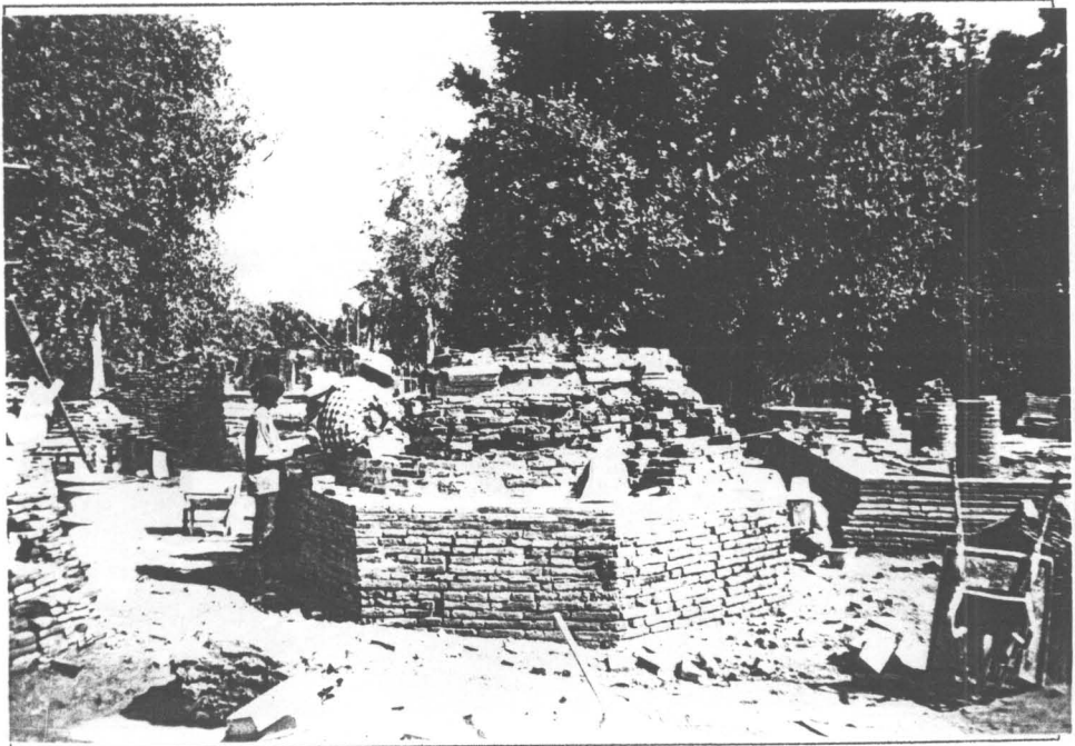
รูปที่ 32 ดำเนินการก่ออิฐเสริมเจดีย์ราย (10/18)
