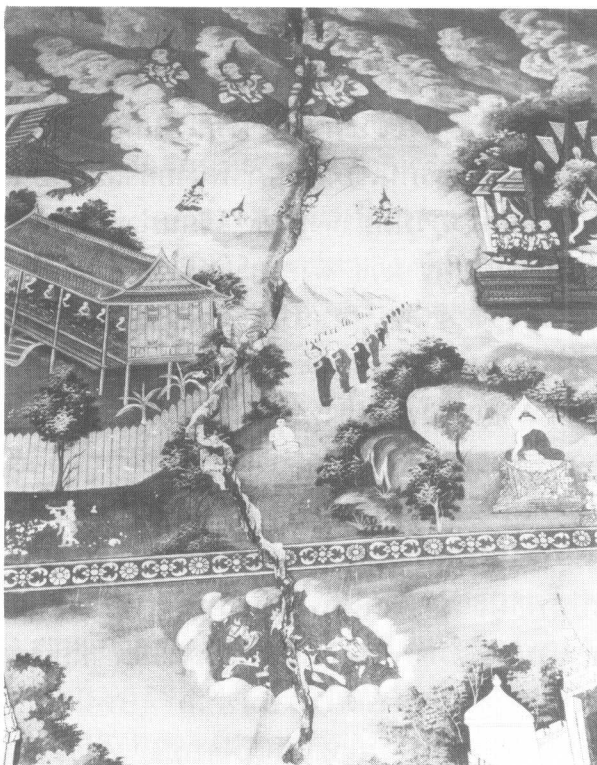
ฝานึงแตกกร้าวแยกออกจากกันเกือบ 2 นิ้ว ฝานึงจะพังลงมาถ้าไม่ได้รับการอนุรักษ์ดูแล
